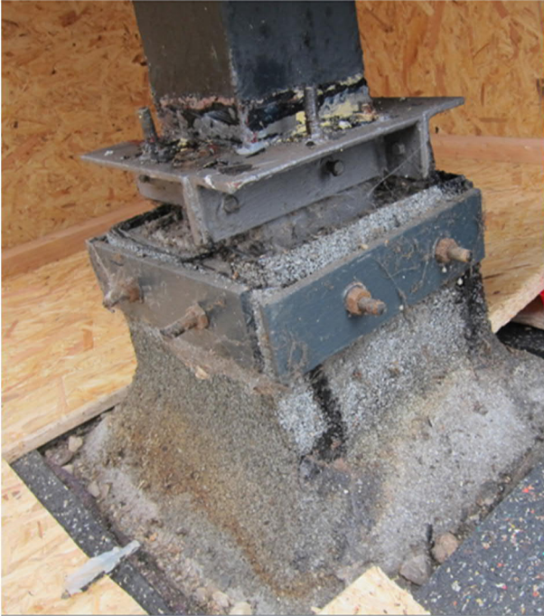
Anbindung der Fachwerkträger (vorher)
